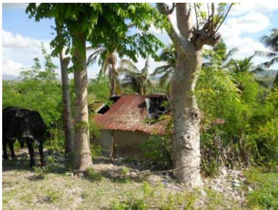
Abbildung 4: Eingefallenes Dach einer haitianischen Hütte
