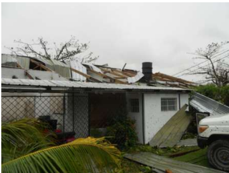
Abbildung 2: Dieses Gebäude wartet noch auf seine Reparatur
