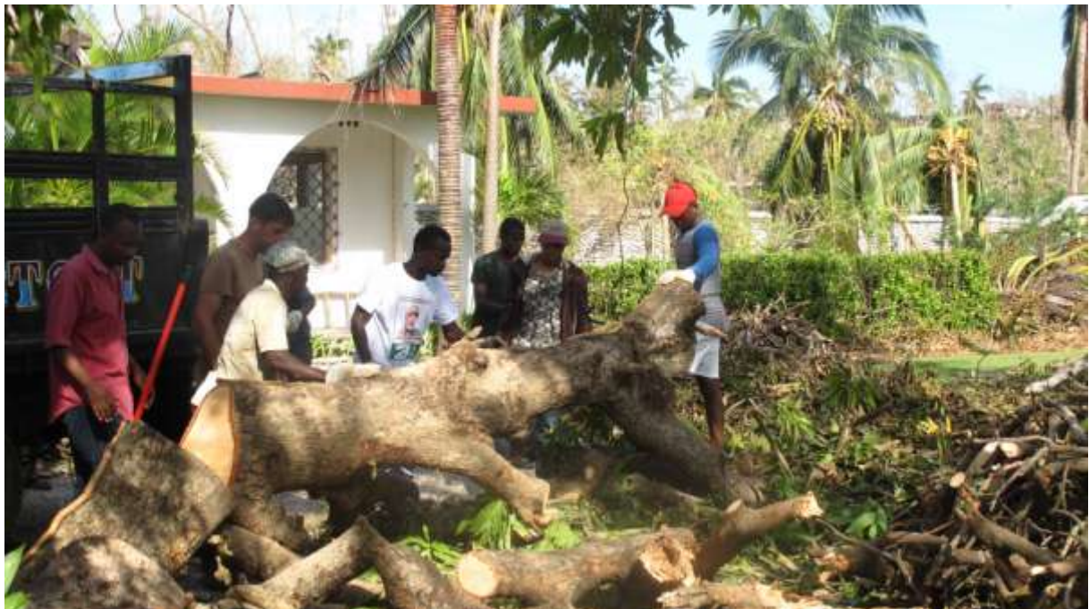
Abbildung 4: Beseitigung eines umgestürzten Baumes am Centre
