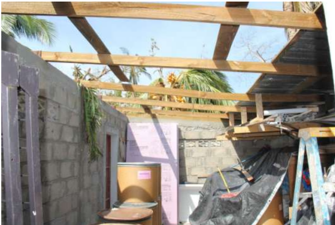
Abbildung 5: Lager - Dach komplett weg
