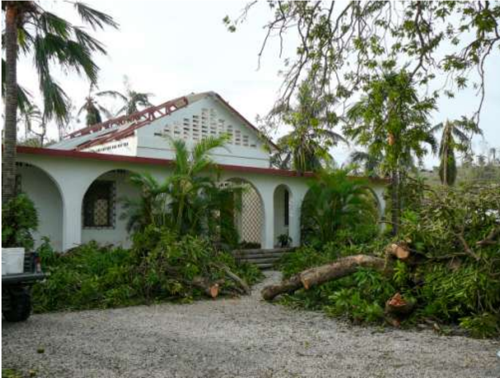
Abbildung 2: Zerstörtes Dach am Büro
